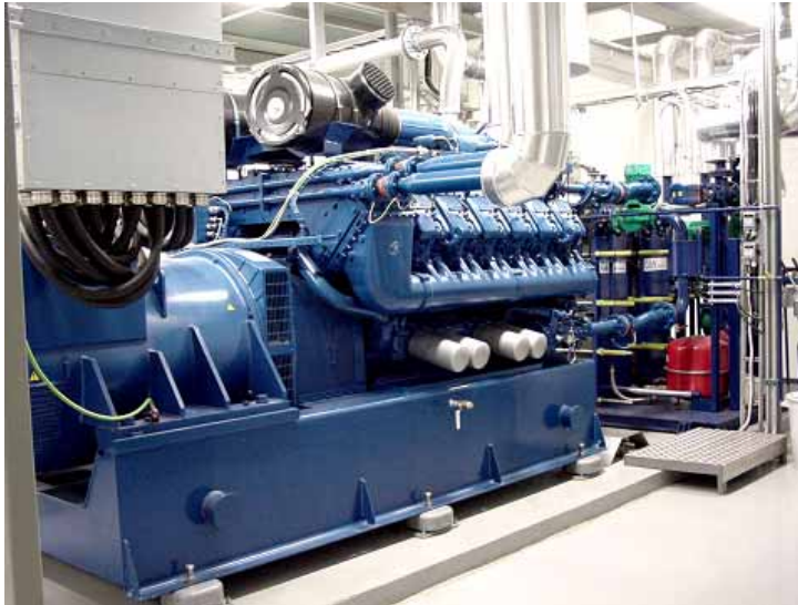
Kaasumootorigeneraattori tuottaa energiaa biokaasusta jätevedenpuhdistamolla.
